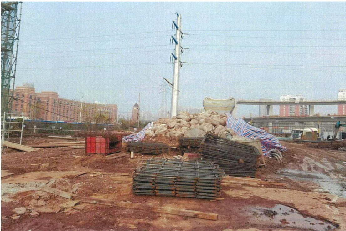
3. 施工区域内施工裸土未覆盖。
